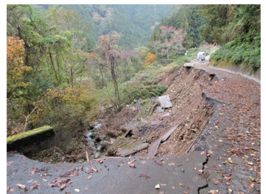
台風被災により崩落した林道
